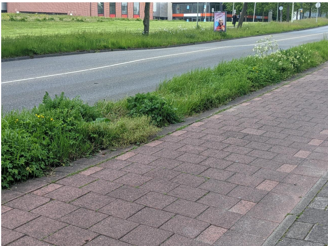
Foto 6: Verzakking wegdek duiker Westlandseweg/Rozenlaan, Maassluis 2021
