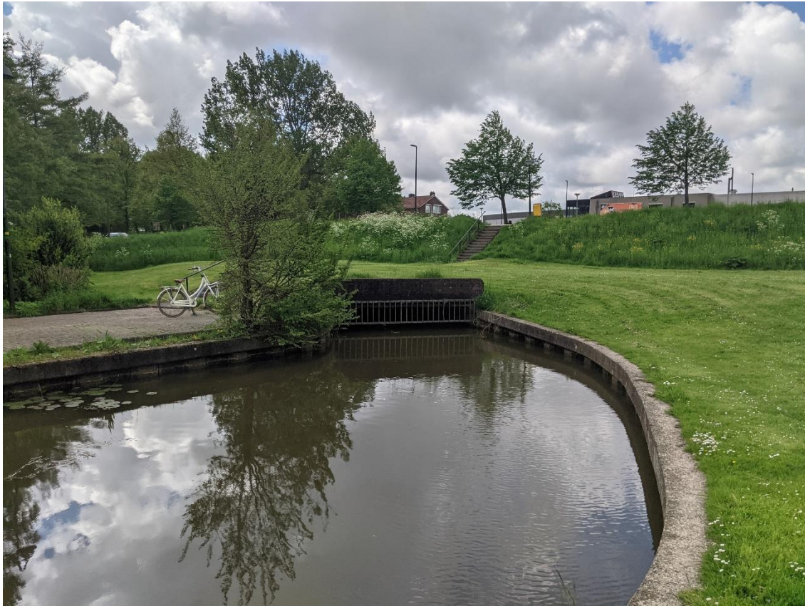
Foto 1: Duiker Westlandseweg/Rozenlaan, Maassluis 2021
