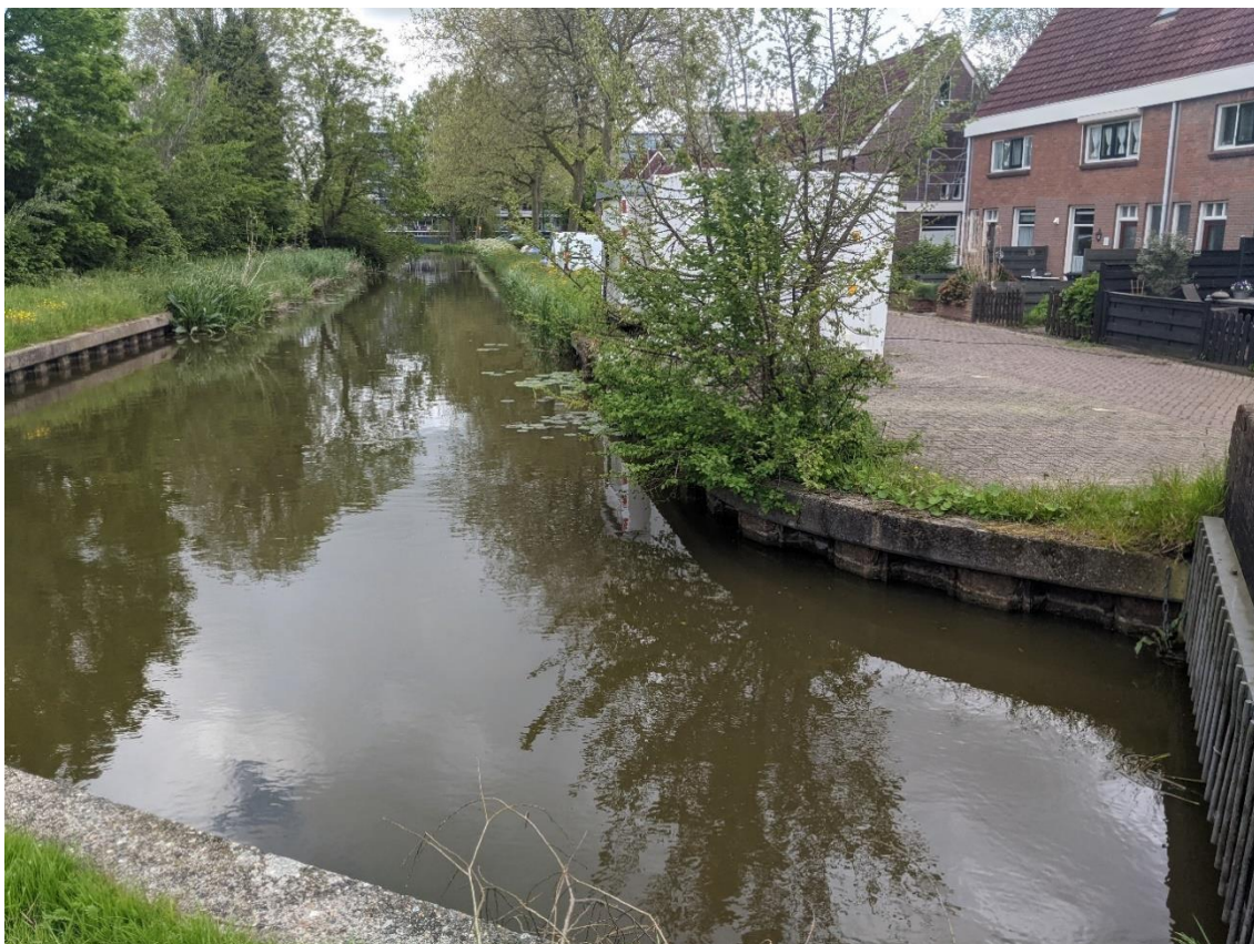
Foto 2: Duiker Westlandseweg/Rozenlaan, Maassluis 2021
