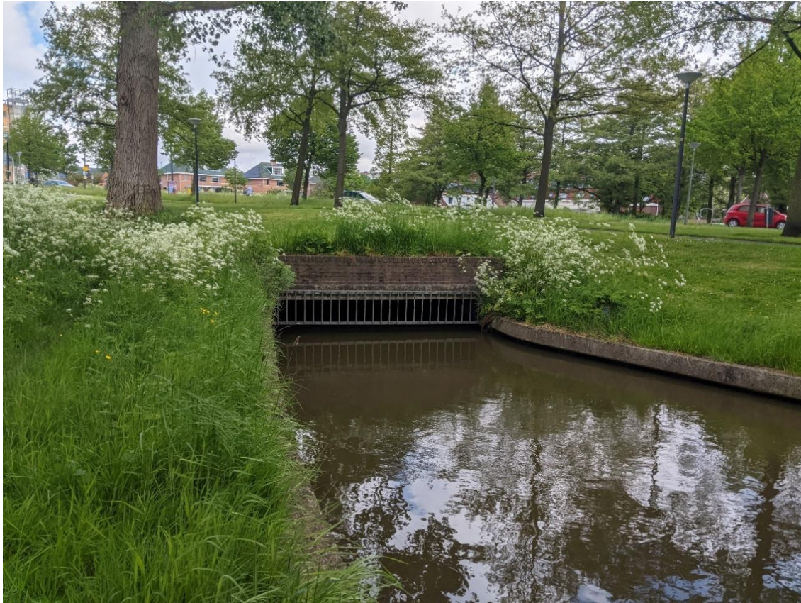
Foto 3: Duiker Westlandseweg/Rozenlaan, Maassluis 2021
