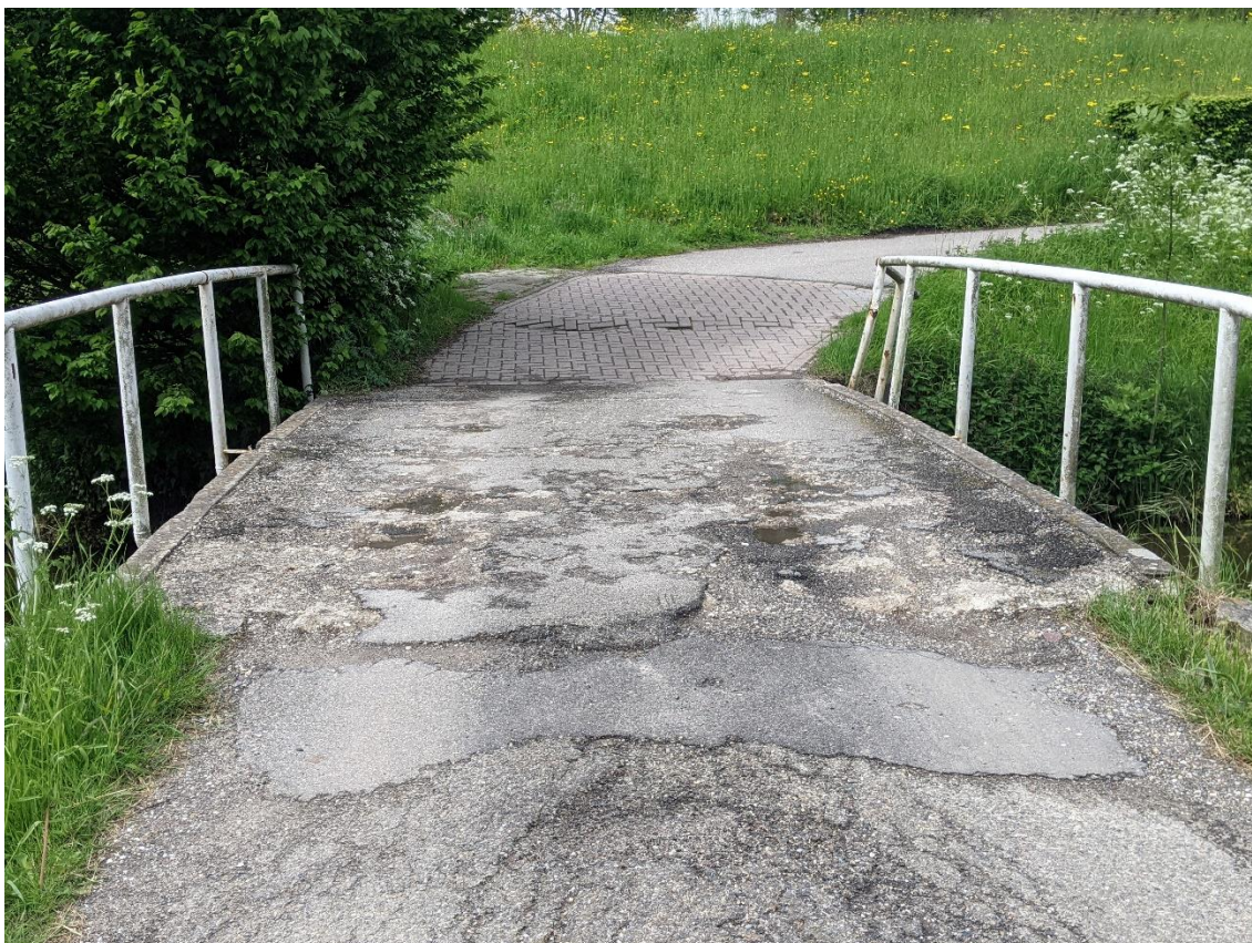
Foto 8: Verouderd wegdek brug over het Nieuwe Water, Maassluis 2021
